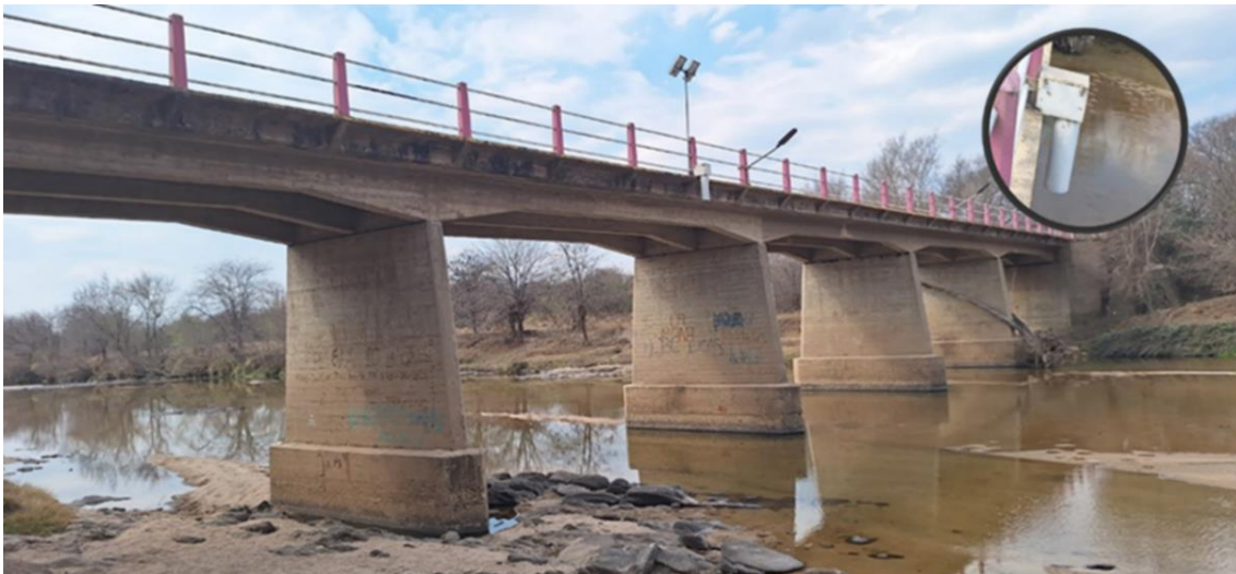
Fotografía 78: Estación limnimétrica automática (ELA) de Aprhi en puente RP23 V.de la Riviera. Foto:Daniel. Ulla
