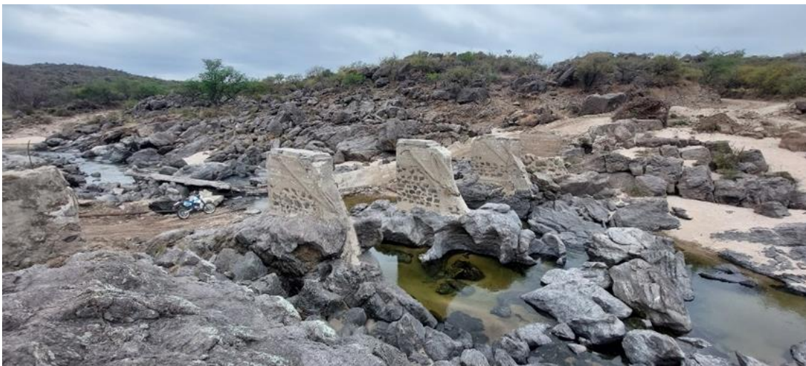
Fotografía 76: Destrucción del puente Videla. Foto: Daniel Ulla.
