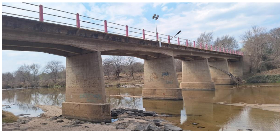
Figura 30. Estación APRHi - Río Quillín. Puente RP 23 y sensor caudalímetro.
