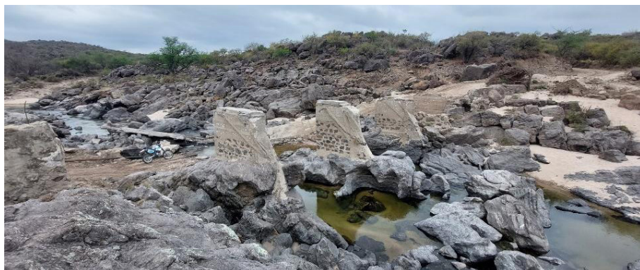
Figura 33. Destrucción del Puente Videla tras la crecida del 22 de marzo de 2023.
